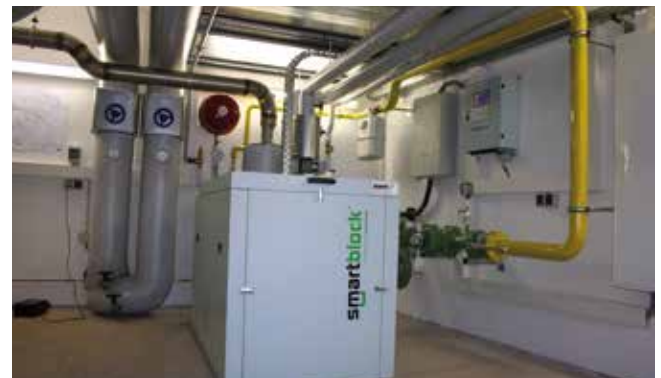
Ein wichtiger Baustein des Neumarkter Klimaschutzes sind KWK-Anlagen (Kraft-Wärmekopplung) mit dezentralen Nahwärmenetzen
