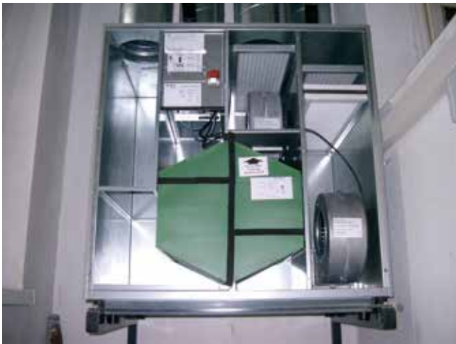
Lüftungsgerät im Innenbereich
